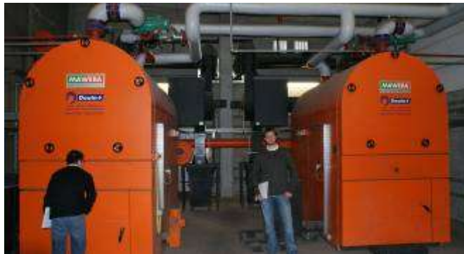
Visite sur site – Atelier du Monceau – Les chaudières bois
