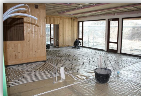
Circuits de chauffage au sol – crèche « Les Jeunes Pousses » Source : Atelier d'architecture DDV
