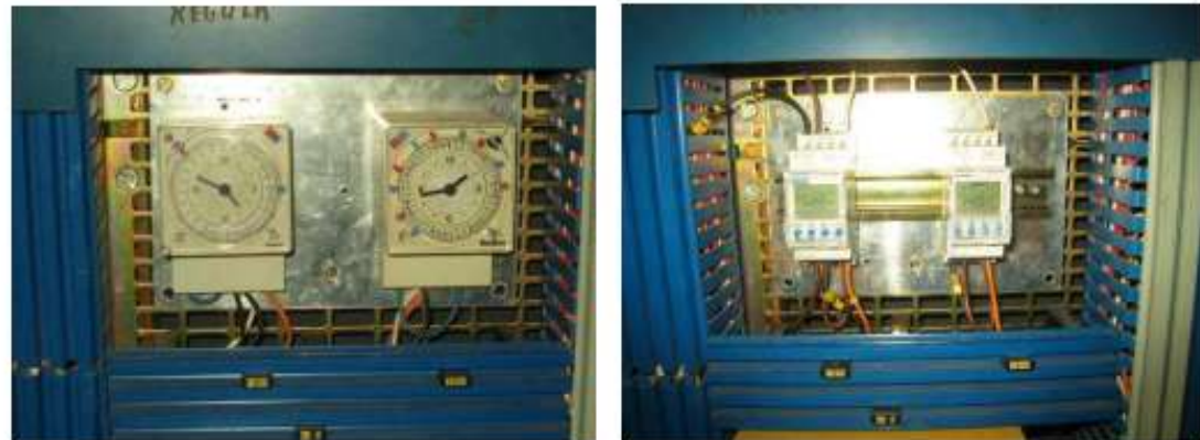
Figure 24 : Régulation horaire (HVAC polyclinique) : avant (gauche) et après (droite)
